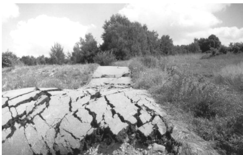
Rys. 1. Zniszczona droga równoległa do osi osuwiska „FALKOWA”
